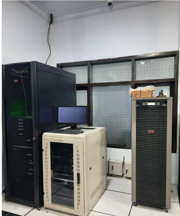
Gambar 29. Ruang Data Center Dinas Komunikasi Informatika dan Persandian Kabupaten Banyuwangi
