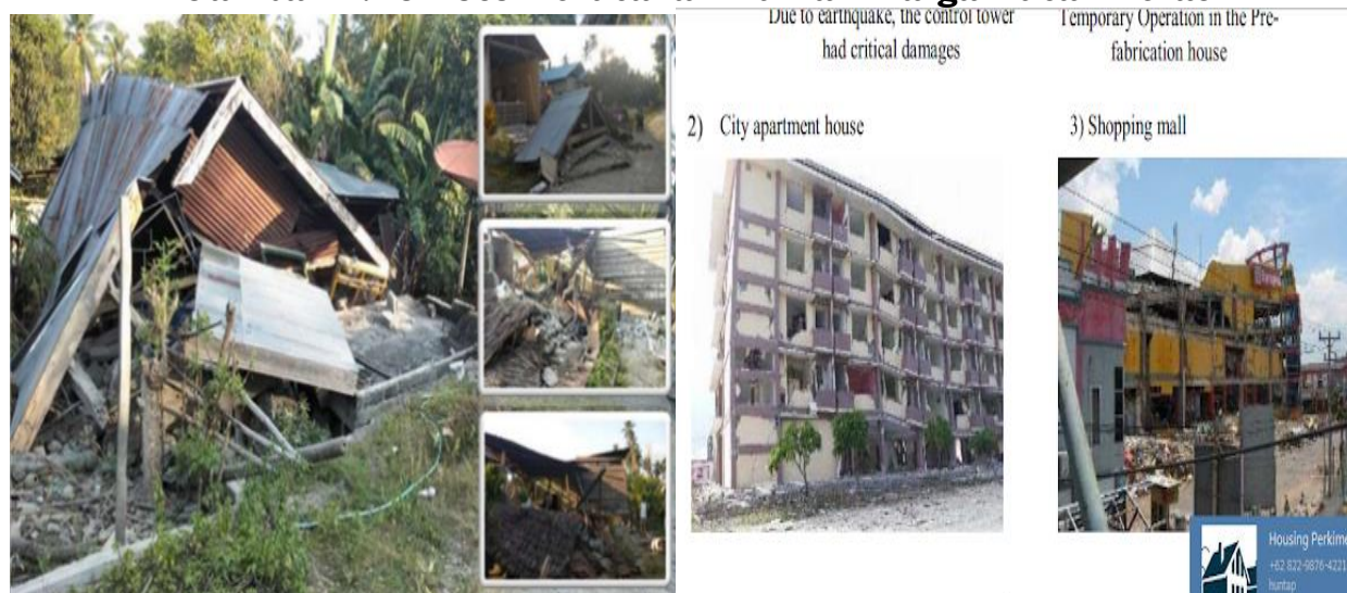
Gambar II.10 Foto Kerusakan Rumah Warga Rusak Berat
