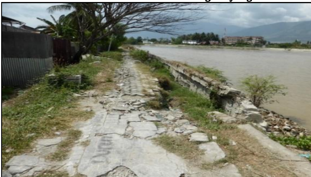
Gambar II.11 Foto Kondisi Jalan Lingkar yang Rusak
