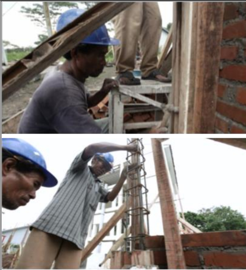
Gambar 57. Pemasangan Beton Dengan Memukul-mukul Cetakan/ Bekisting dan Campuran Beton Dirojok Menggunakan Besi atau Bambu
