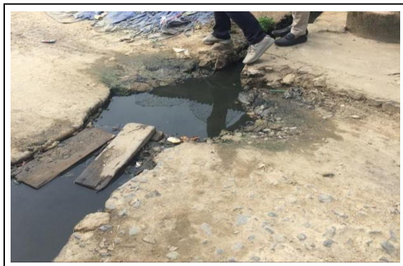
Gambar 5. Contoh kondisi permukaan jalan lingkungan yang rusak
