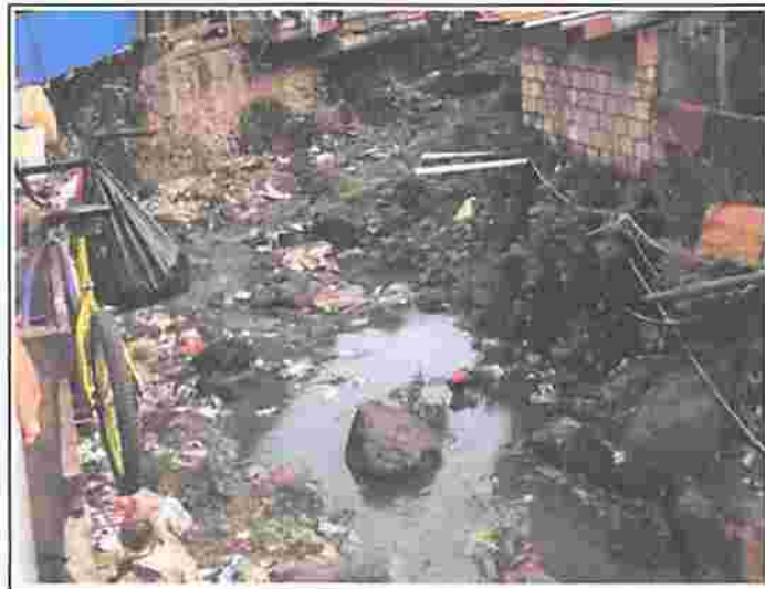
Gambar 9. Contoh Kondisi Saluran Pasangan Batu yang Rusak (Sumber: Peraturan Menteri Pekerjaan Umum Nomor: 14/PRT/M/2018)
