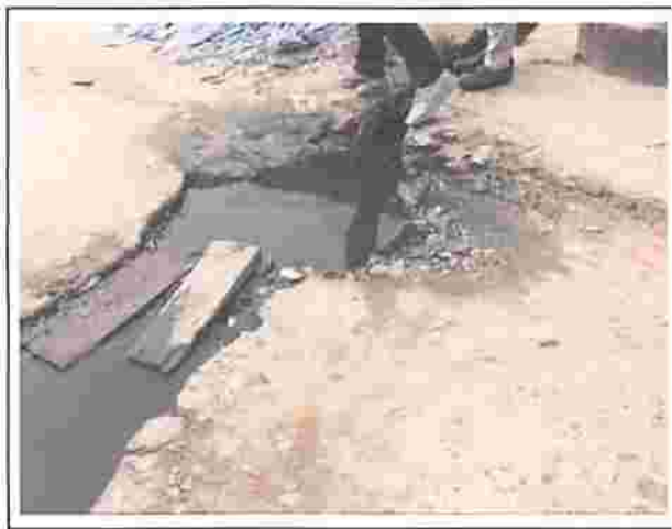
Gambar 5. Contoh Kondisi Permukaan Jalan Lingkungan yang Rusak
