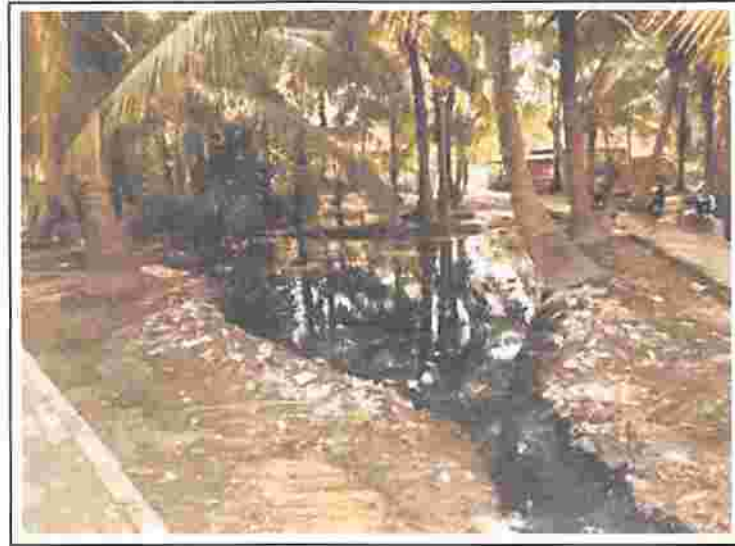
Gambar 8. Contoh Kondisi Genangan di Samping Jalan Lingkungan (Sumber: Peraturan Menteri Pekerjaan Umum Nomor: 14/PRT/M/2018)
