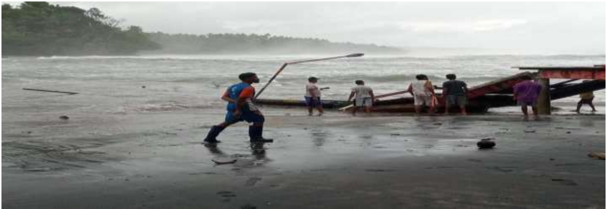
Gambar 5. Dermaga Tambatan Perahu Rusak Akibat Cuaca Ekstrim dan Gelombang Pasang
