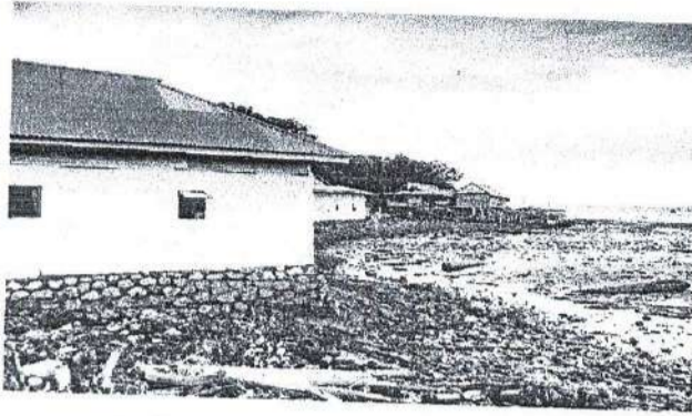
Kondisi Rawan Abrasi Pantai
