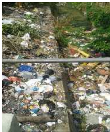
Gambar 2.9 Saluran Drainase di RS Sriwijaya
