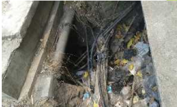
Gambar 2.7 Saluran Drainase di Air Paoh
