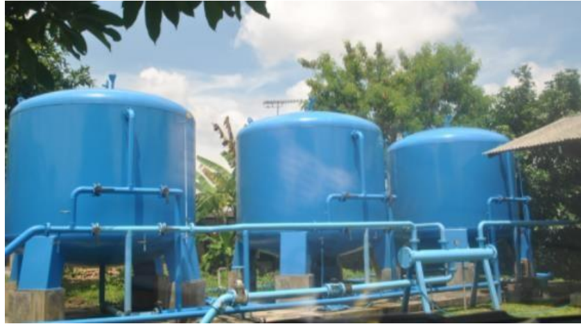
Gambar 8. 6. Instalasi Pengolahan Air
