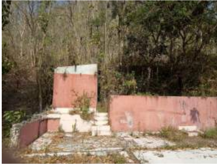
Gambar.2.12 Kerusakan rumah akibat adanya bencana gerakan tanah.
