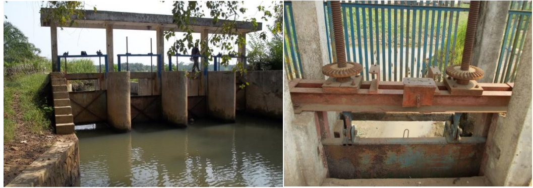
Gambar 4 Pintu skot balok
