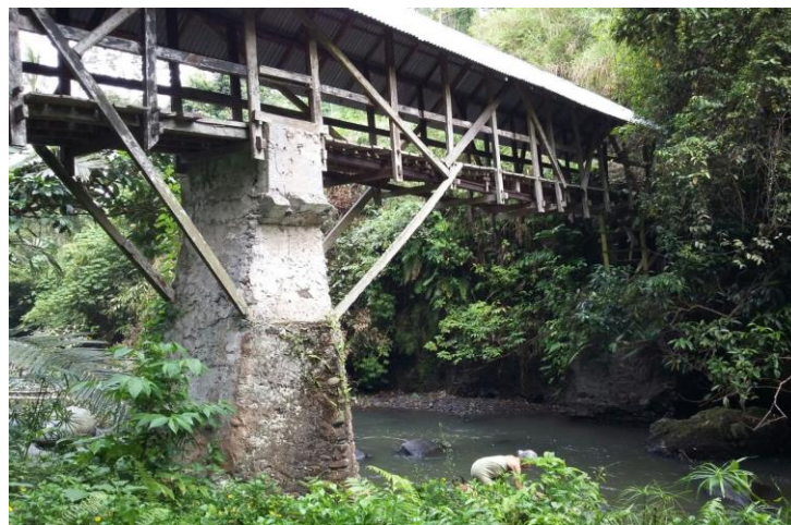
Jembatan Tanjung Gunung Rajo yang menghubungkan Nagari Gunung Rajo Pitalah tidak bisa dilalui kendaraan bermotor
