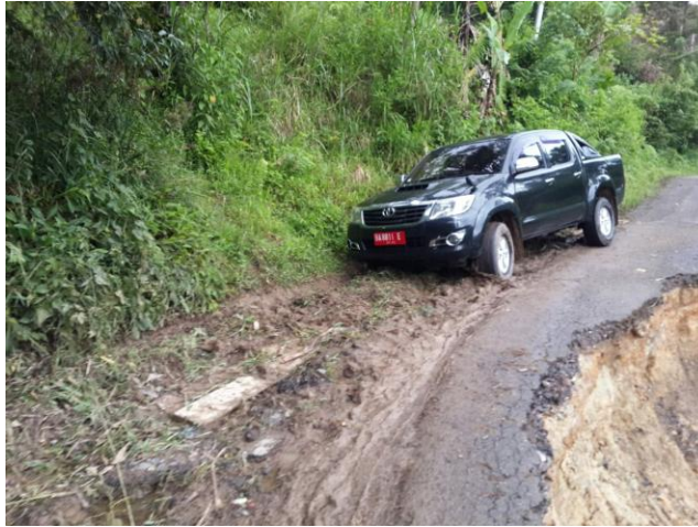
Jalan Tambangan- Gunung Bungsu yang terban/longsor karena tingginya curah hujan
